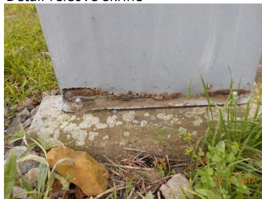
Detail reléové skříně
