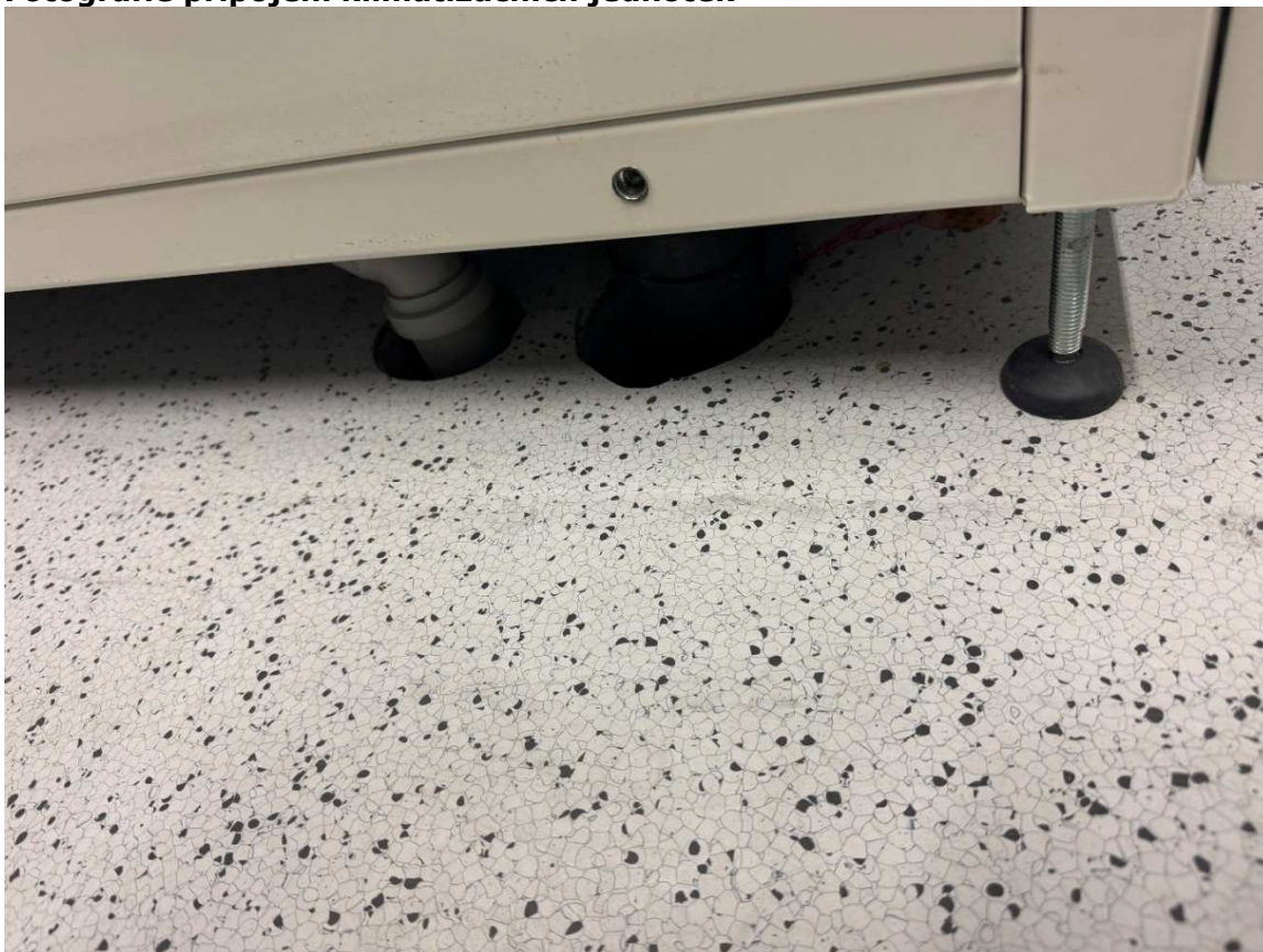
Fotografie připojení klimatizačních jednotek
