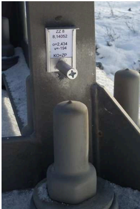
Obrázek 9 Konzolová značka na podpěře trakčního vedení
