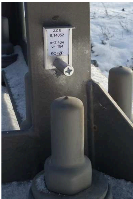
Obrázek 9 Konzolová značka na podpěře trakčního vedení
