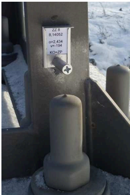
Obrázek 9 Konzolová značka na podpěře trakčního vedení
