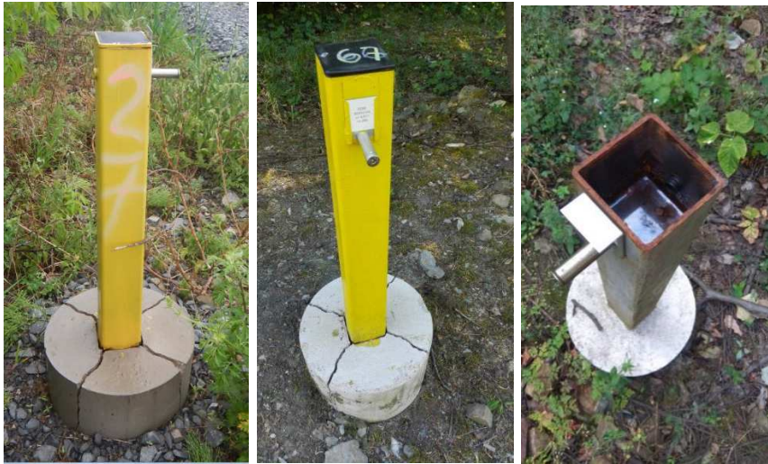
Obrázek 19 Popraskané betonové základy zajišťovacích značek ŽPSV
