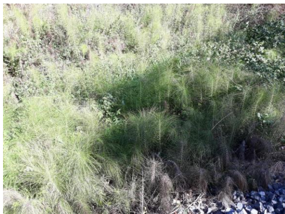
Obr. 3 Porost nezpevněného příkopu přesličkou
